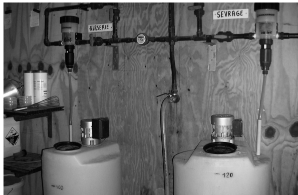
ドサトロンと薬液タンク タンク上部の銀色の円柱が攪拌機のモーター
