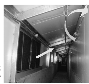
水で冷やされた空気は天井裏から室内へ入る
