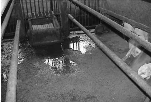
写真1 コンクリートの床が削られてできた水たまり
